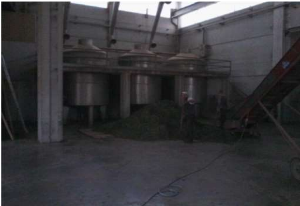
Fig. 67: alambicchi per la distillazione, il vapore viene generato da un'apposita caldaia.
